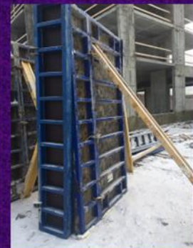
Нарушение порядка складирования
