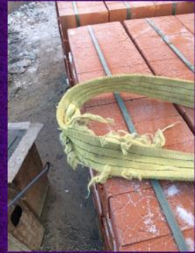
Использование неисправных стропов
