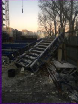
Нарушение порядка складирования
