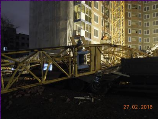
Авария ООО Кран Сити, г. Екатеринбург
