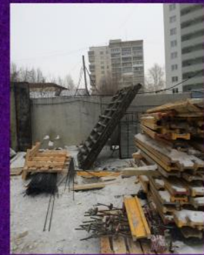
Нарушение порядка складирования
