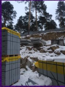
Нарушение порядка складирования
