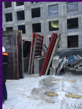
Нарушение порядка складирования
