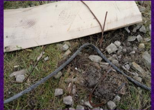
Использование неисправных стропов
