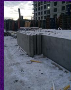
Нарушение порядка складирования
