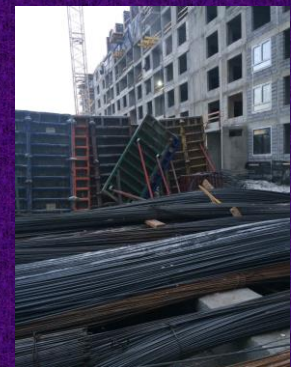
Нарушение порядка складирования
