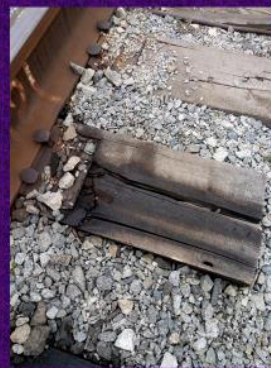
Наличие шпал рельсового пути с дефектами
